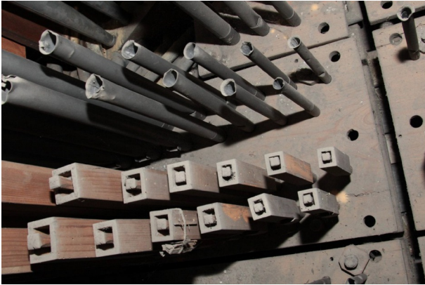
Poškození červotočem, celkové zanesení
